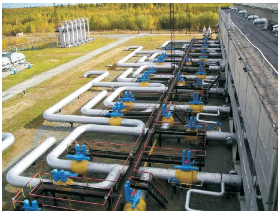
Рис. 1. Пример трубопроводов с ТПА
